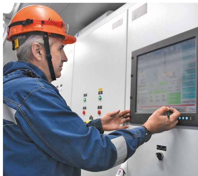
Ведущий специалист по наладке и эксплуатации РЗА и КИПиА ООО «БНГРЭ» Василий Сергиенко проверяет режим работы энергетического оборудования
